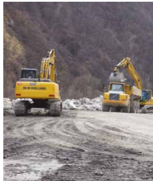
▲ La réalisation des enrochements d'un des sites de dépôts a été confiée à des entreprises locales
