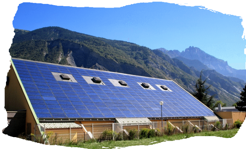
Figure 54 - Centrale solaire SOREA à Saint-Julien-Montdenis Source : http://www.sorea-maurienne.fr/centrales-solaires.html
